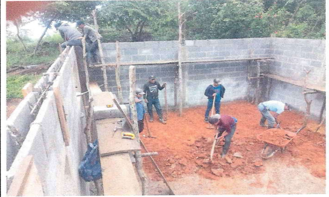
Foto 2: mejoramiento por falta de block
